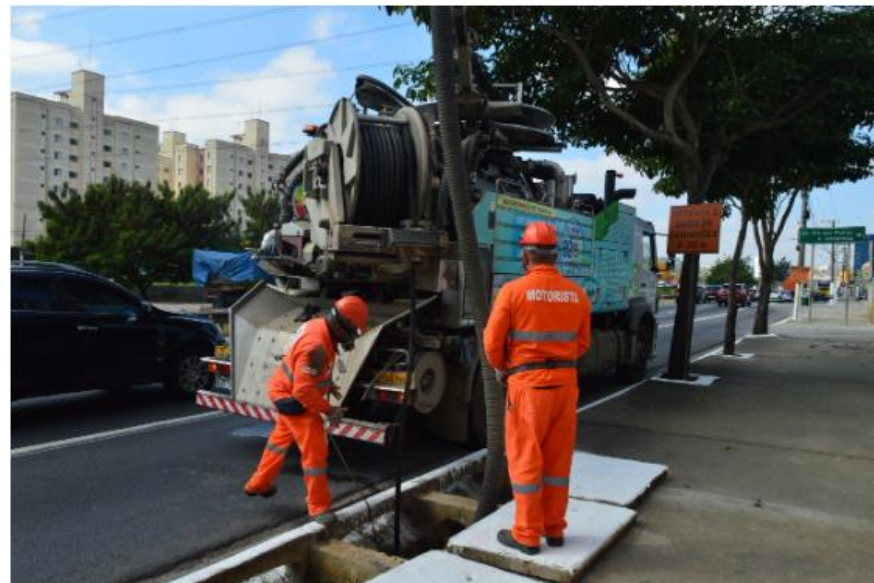
Legenda: Exemplo de Serviço de Microdrenagem.
